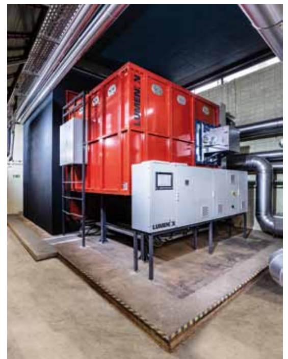
Hochtemperatur-Stahlspeicher im Pilotprojekt
