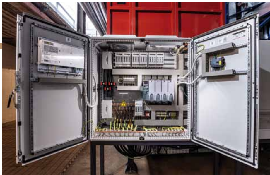
Steuerung des Hochtemperatur-Stahlspeichers
